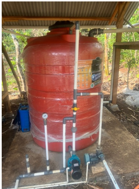
Gambar 5. Central Water Tank dengan Pompa Sirkulasi (kanan) dan Pompa Irigasi (kiri) (sumber: pribadi)
